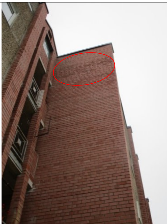
4.2.3. att. Ķieģeļu virsējās kārtas erozija
