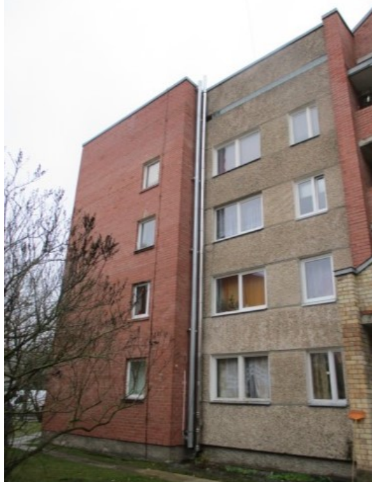
4.14.1. att. Funkcionējoši dūmeņi
