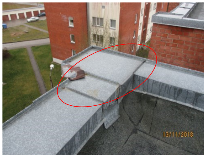
4.8.10. att. Nekvalitatīvi izbūvēts skārda ielāps
