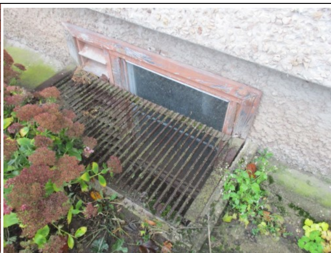
4.13.2. att. Koka konstrukcijas logi pagrabstāvā
