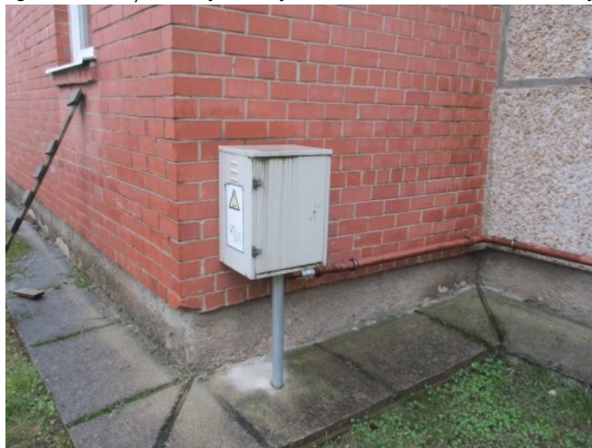
5.8.1. att. Gāzes skapis ēkas dienvidu puses fasādē
