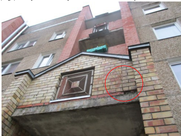
4.2.5. att. Lokālu ķieģeļu mūra erozija (iesakņojies koks)
