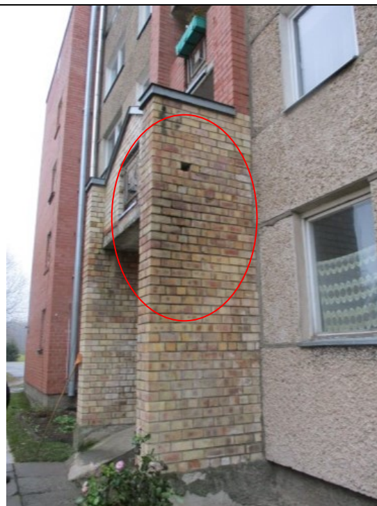
4.2.4. att. Pelējums un ūdens notecējumi uz virsmas
