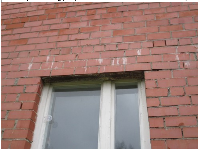
4.2.1. att. Metāla pārsedžu virsmas korozija
